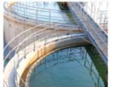
Su / Atık su
